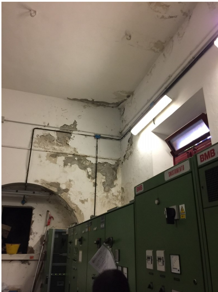
Figura 9: infiltrazioni sala macchine – Stazione di Monte
