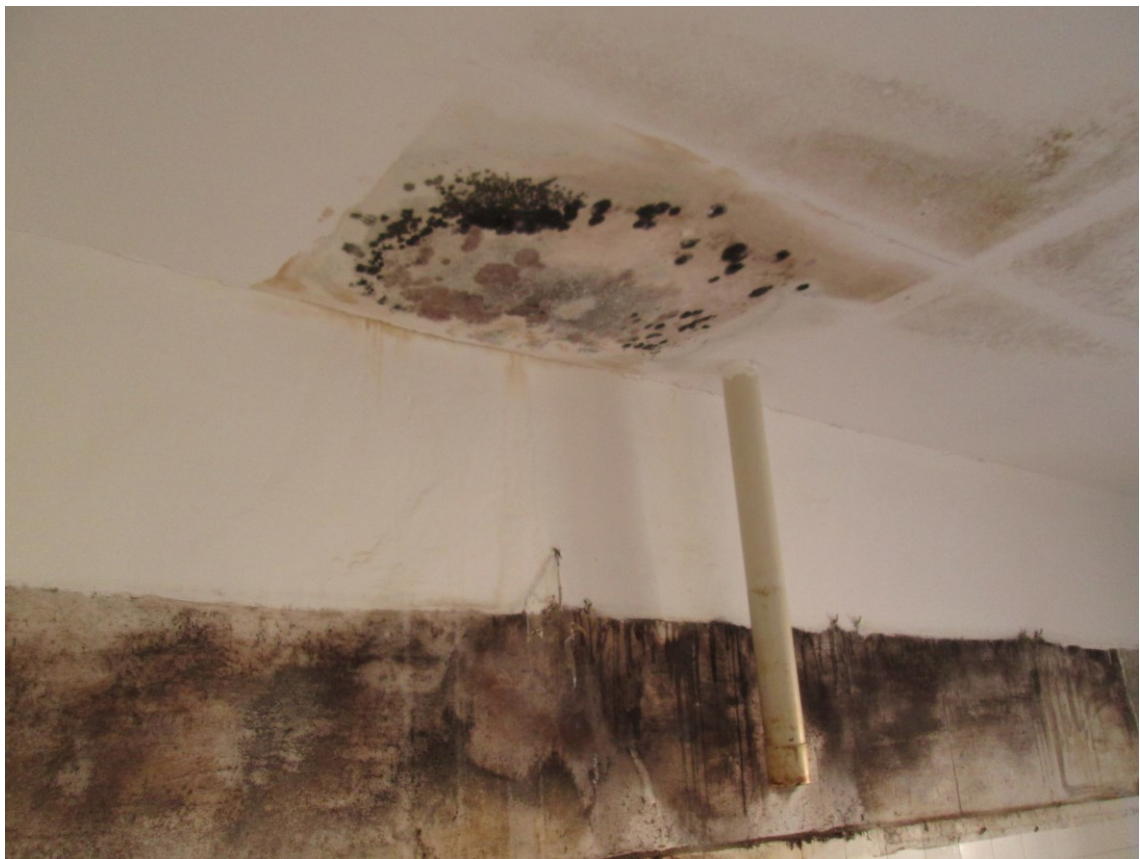
Figura 4: infiltrazioni controsoffitto copertura – Stazione di Valle
