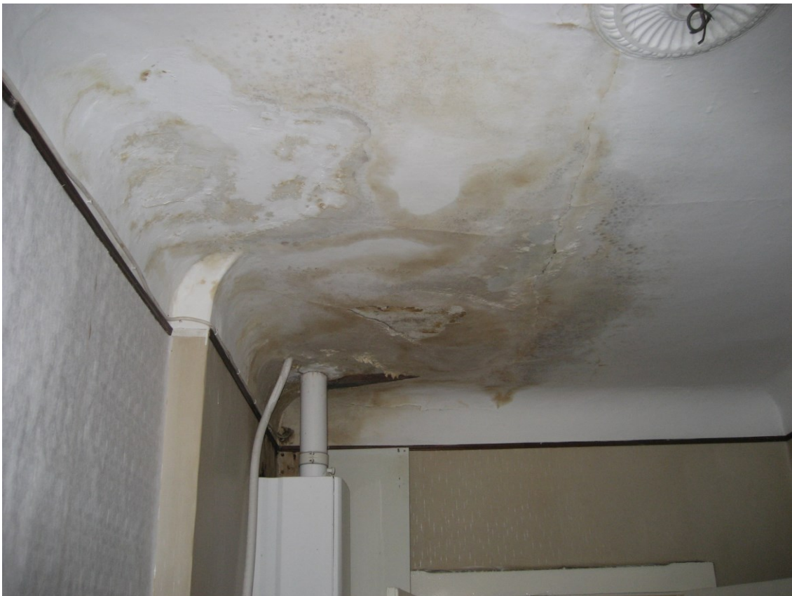
Figura 3: infiltrazioni controsoffitto copertura – Stazione di Valle
