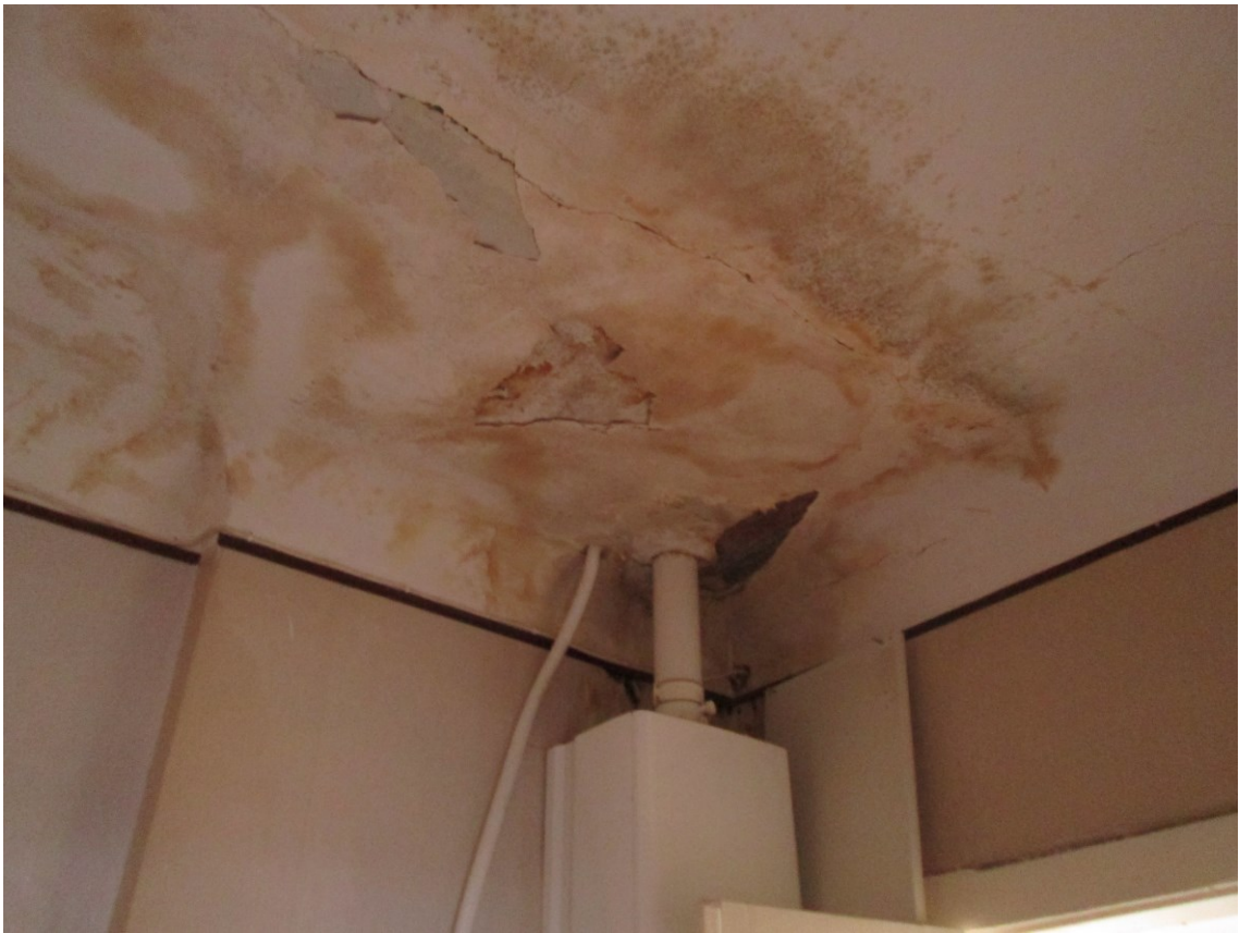
Figura 2: infiltrazioni controsoffitto copertura – Stazione di Valle
