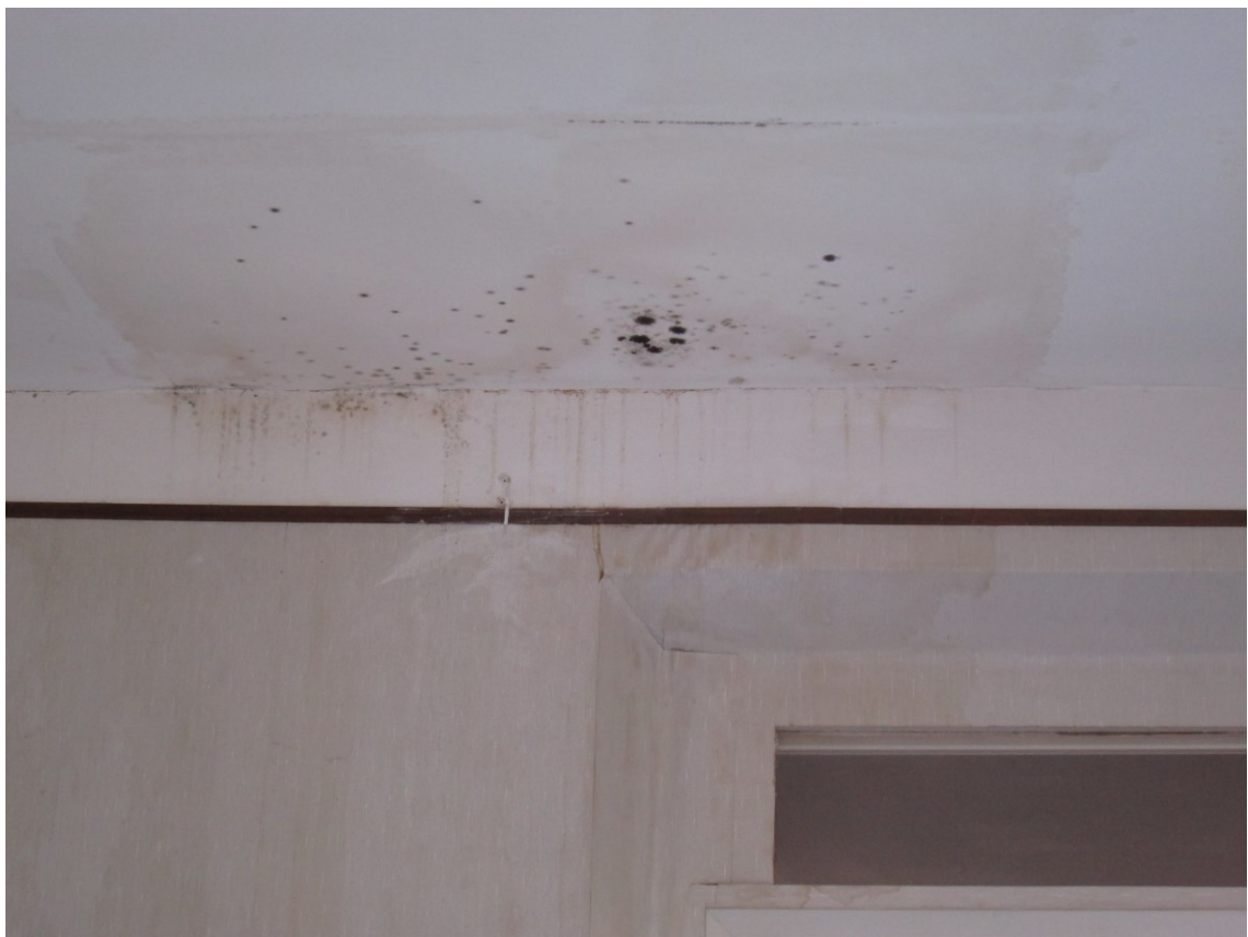
Figura 5: infiltrazioni controsoffitto copertura – Stazione di Valle
