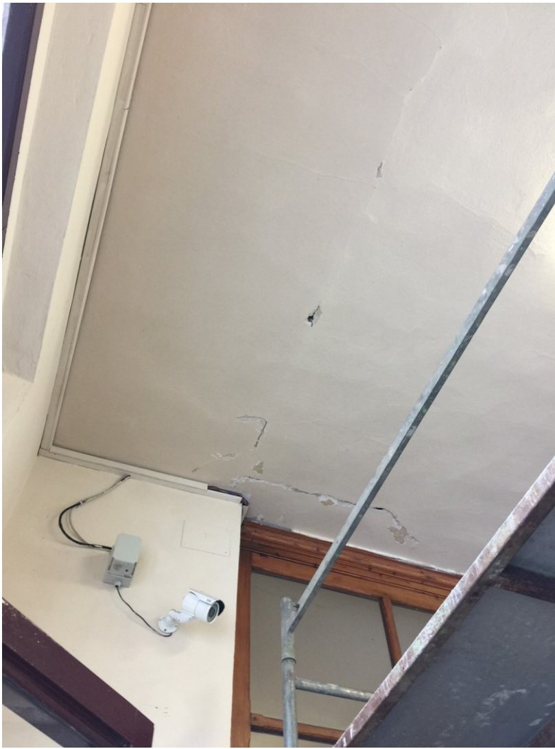
Figura 8: danneggiamento controsoffitto biglietteria – Stazione di Valle
