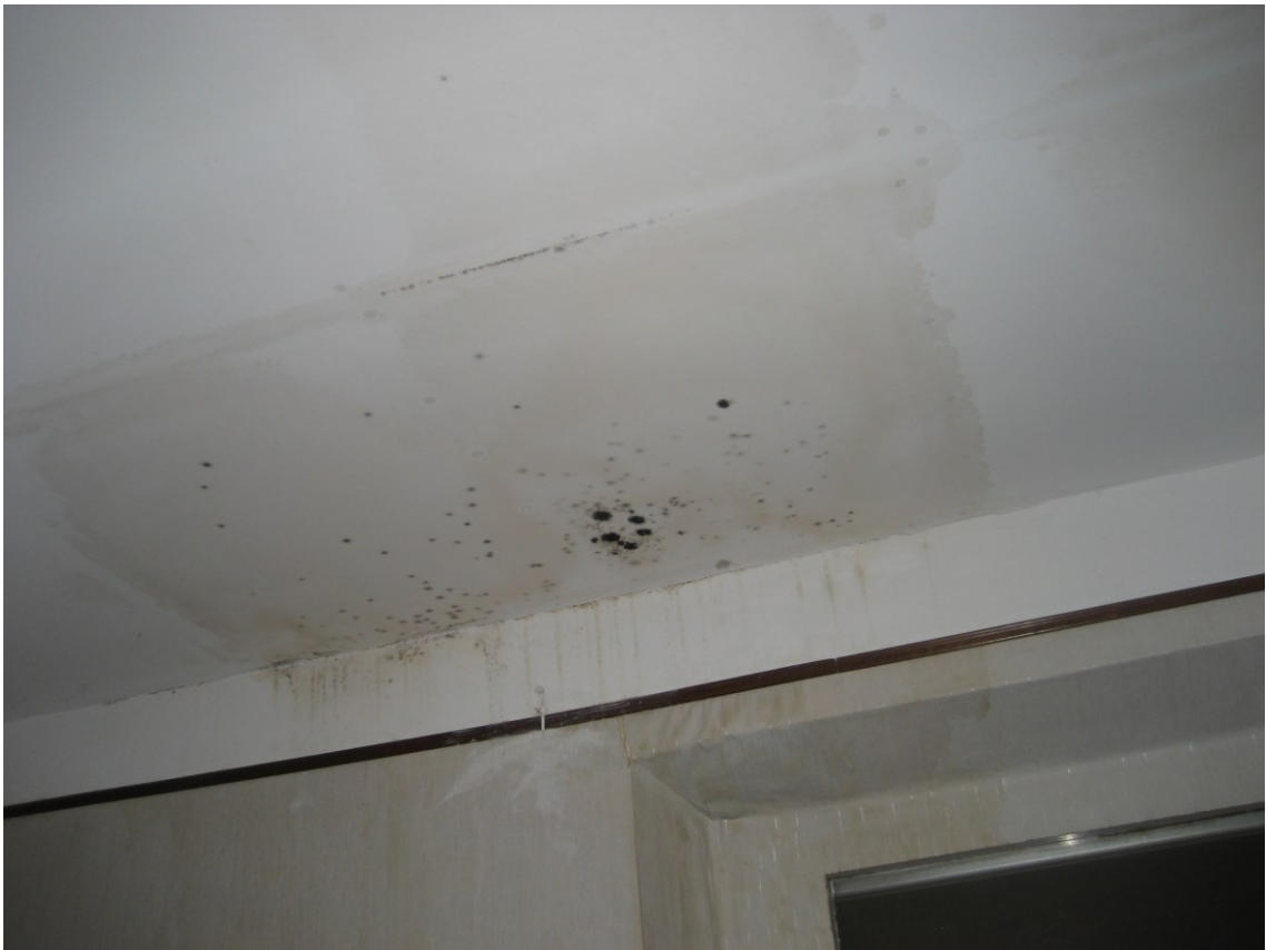
Figura 6: infiltrazioni controsoffitto copertura – Stazione di Valle
