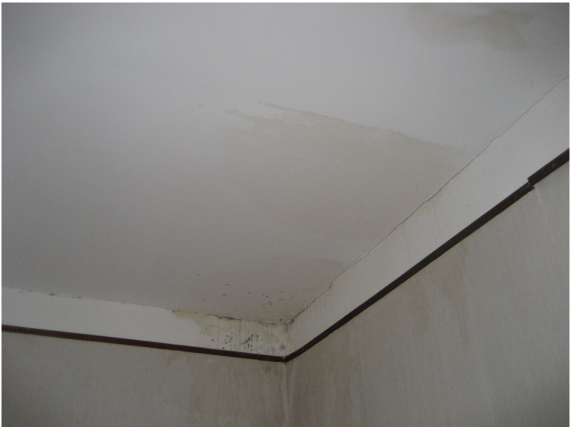
Figura 7: infiltrazioni controsoffitto copertura – Stazione di Valle
