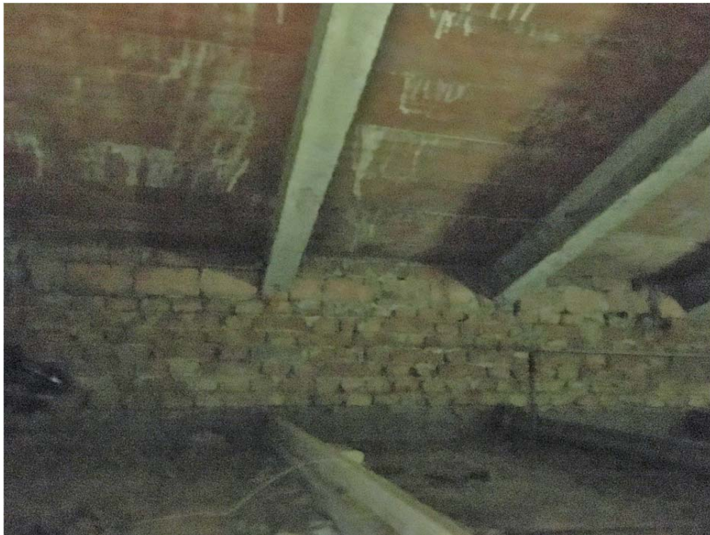
Fig. 2.6– Assenza di cordolo perimetrale in copertura plesso US1
