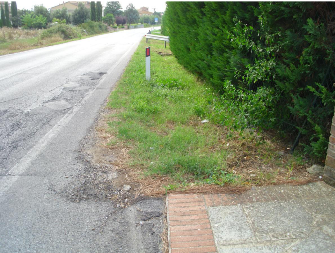
Zona termine impianto di illuminazione all' ingresso del Podere S. Guglielmo. Vista verso sud
