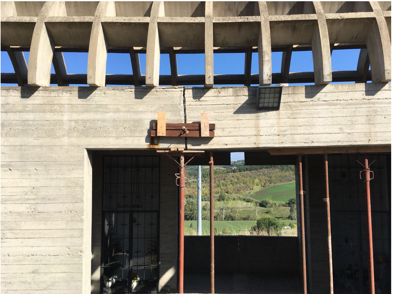
Figura 3 – LESIONI PER CEDIMENTI FONDALI
