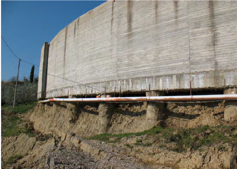
Foto 1 – Nicchia di distacco della frana in corrispondenza del lato Est del Cimitero (Marzo 2011)
