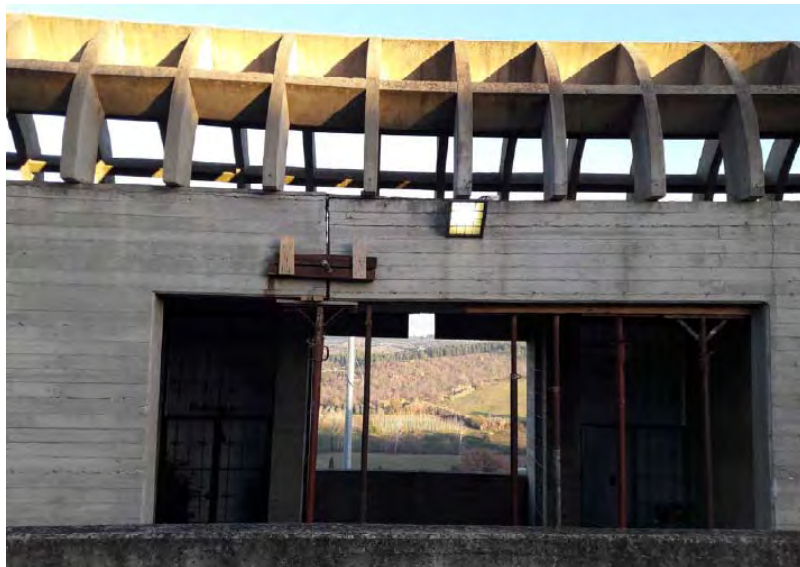
Foto 7 – Lesioni sul muro perimetrale del corridoio loculi – Novembre 2017
