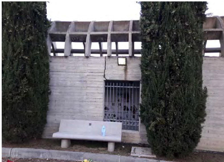
Foto 6 – Lesioni sul muro perimetrale del corridoio loculi – Novembre 2017
