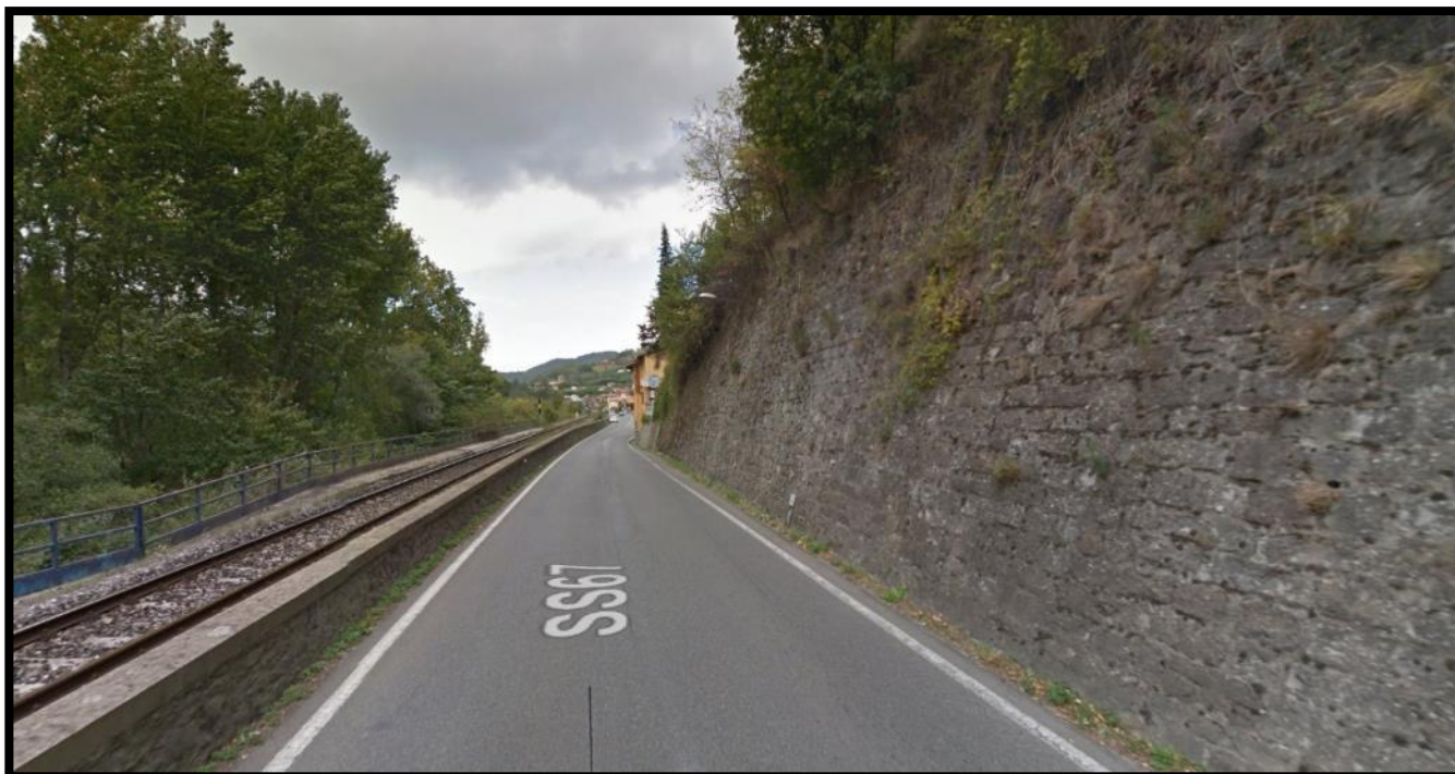
Figura 6: Strada S.S. 67 chilometrica 116-VI direzione Nord (fra Piandrats e Dicomano) – Assenza di marciapiede e banchina stretta
