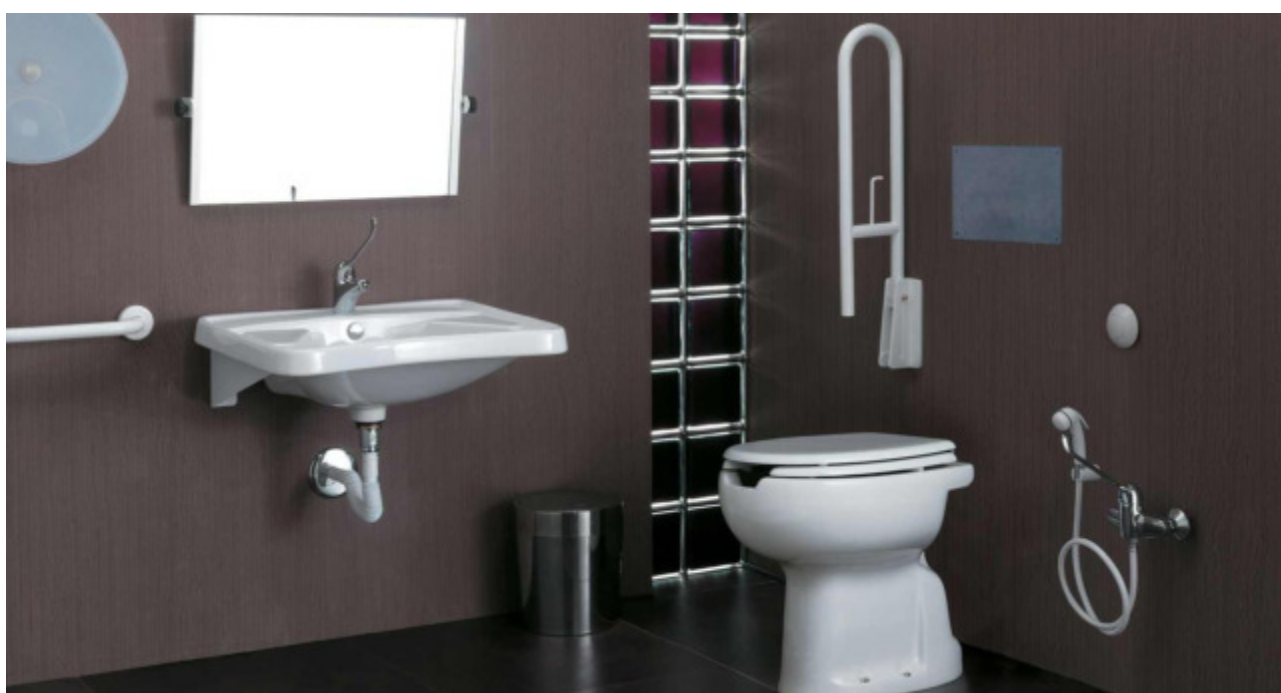
Fig. D-11) Il contrasto cromatico tra pareti di fondo e sanitari/attrezzature di un servizio igienico agevolano la percepiibilità/leggibilità dell'ambiente anche da parte di persone con vista debole, ipovedenti, ecc..
