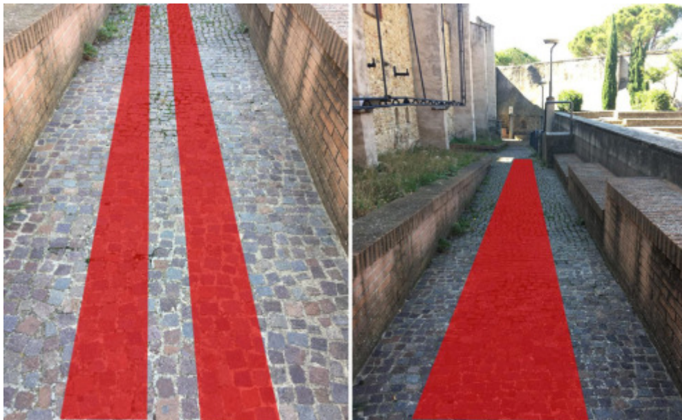
Fig. B-11) Accesso da via Lucardesi, per migliorare la percorribilità delle rampe da parte di utenti su sedia a ruote potrebbe essere utile creare delle fasce (unica o a binario) di superficie levigata e resacomplanare. Propedeutico a questa operazione è la valutazione della stabilità della pavimentazione, la rigenerazione dei giunti logori e della superficie pavimentale nel suo complesso.
