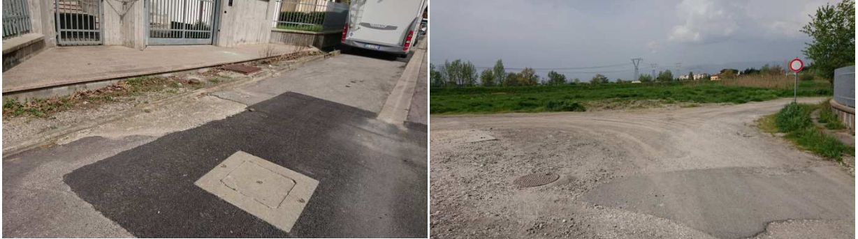
Figura 10 Stato attuale Via Cegoli
