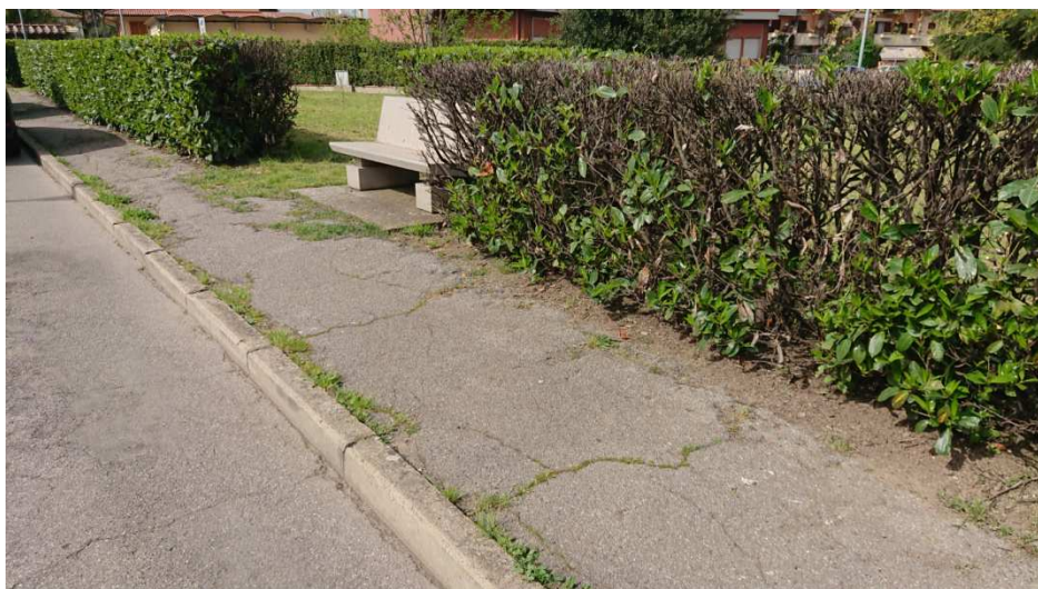
Figura 6 Stato attuale Via Cegoli
