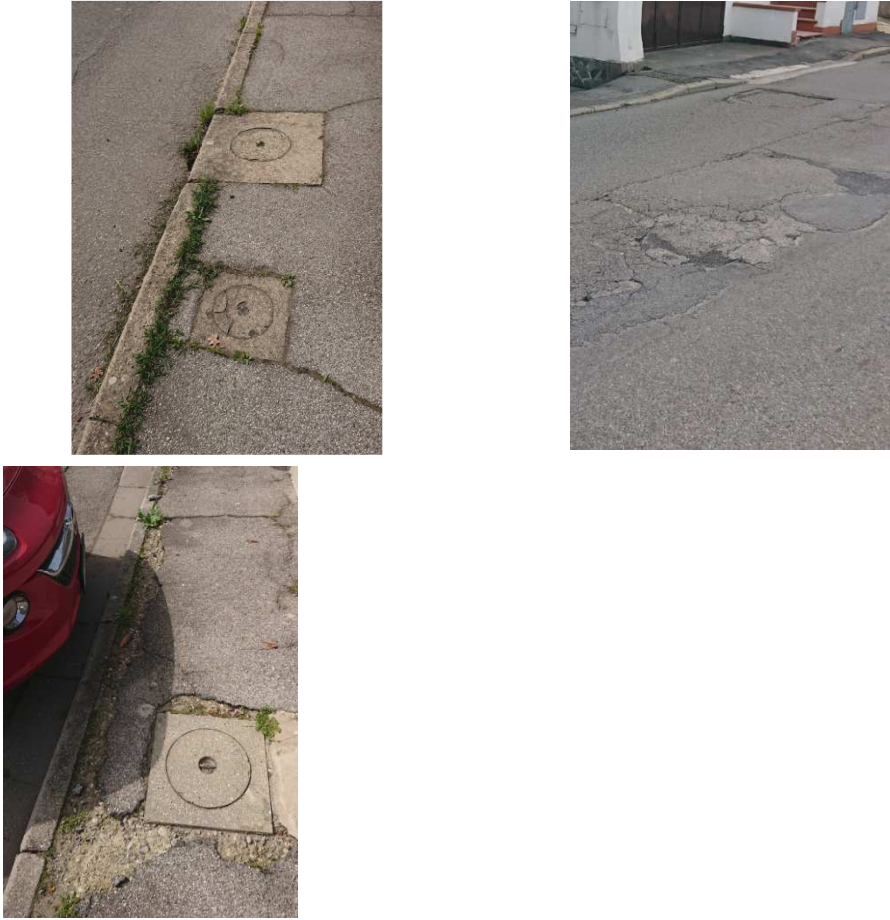
Figura 3 Degrado dello stato attuale di chiusini, pavimentazione stradale e marciapiedi
