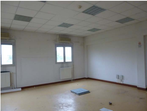
Piano primo con infiltrazioni sopra le finestre
