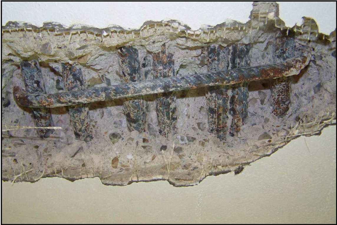
Foto 3 - Armatura presente all'intradosso delle mezzeria della trave centrale
