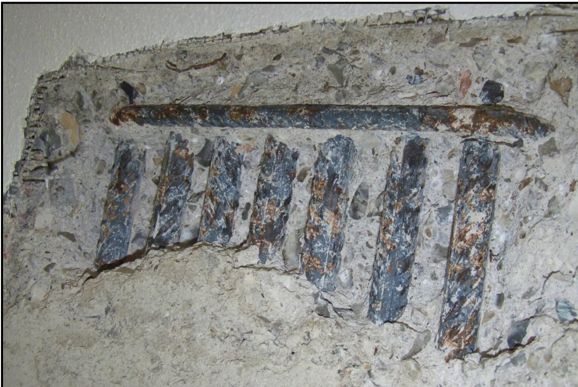
Foto 2 - Armatura presente all'intradosso delle mezzeria della trave di bordo
